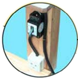
ตำแหน่งติดตั้งเบรกเกอร์
